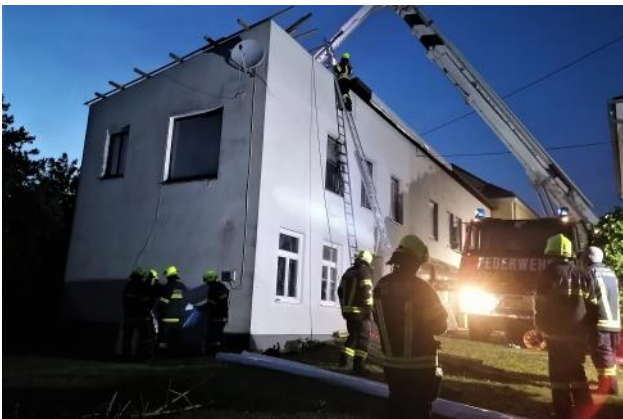
Abgedeckte Dächer im Ortszentrum nach Sturm am 19. August - Unterstützung durch die BTF Steyerrmühl
